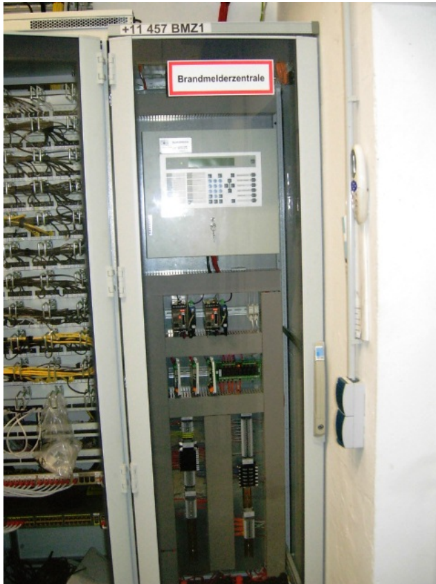
Abbildung 13: Schaltschrank für Brandmeldezentrale einbau
