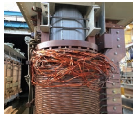
Wicklungsschaden 30kV Trafo
